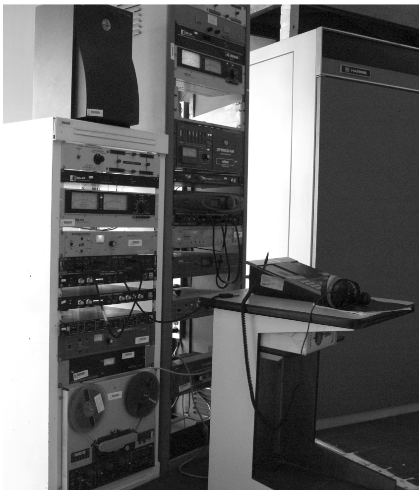
Equipos de transmisión.
